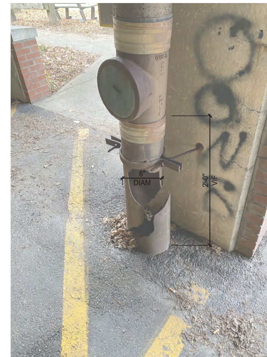
23 BROKEN PIPE AT LOWER LEVEL SCALE: N.T.S.
