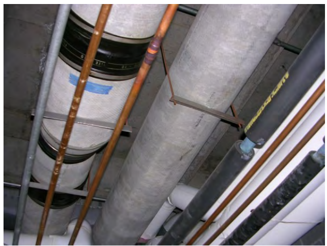
HA 08 Transite Fume Exhaust Duct
