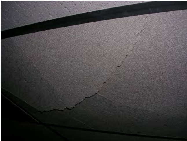
HA 96 Styrofoam Ceiling Tile
