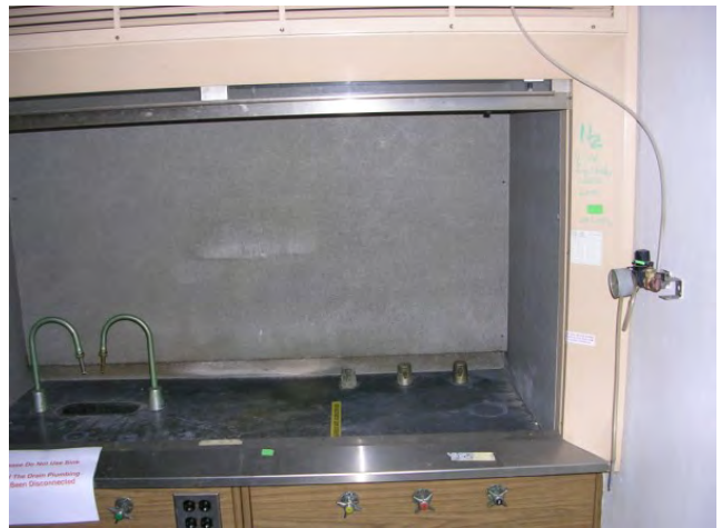
HA 06 Transite Fume Hood
